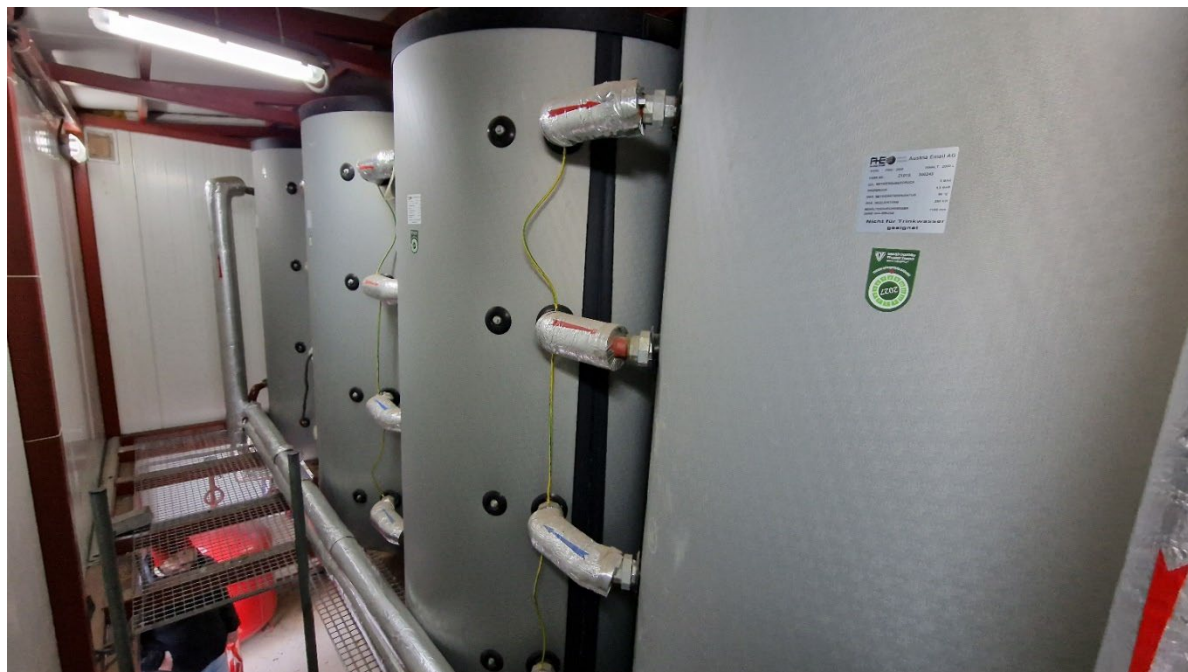
Zdj. 3 Kotłownia instalacji solarnej, zbiorniki buforowe.
